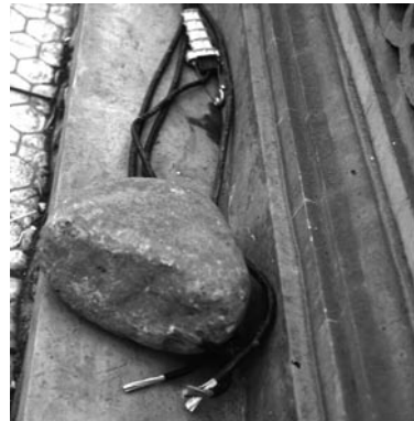
●道端に転がるぶった切られた電線…。
